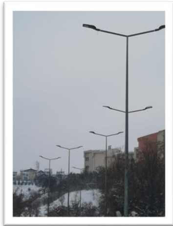
Resim.2.1.4.b. Kampüs Yollarında Yer Alan Diğer Aydınlatmalar
