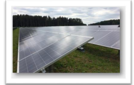
Resim.2.3.1.f. Orman Alanındaki Güneş Panelleri
